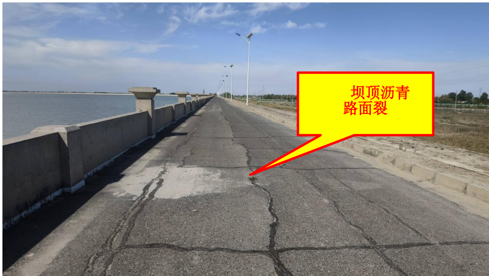
坝顶沥青路面裂缝
