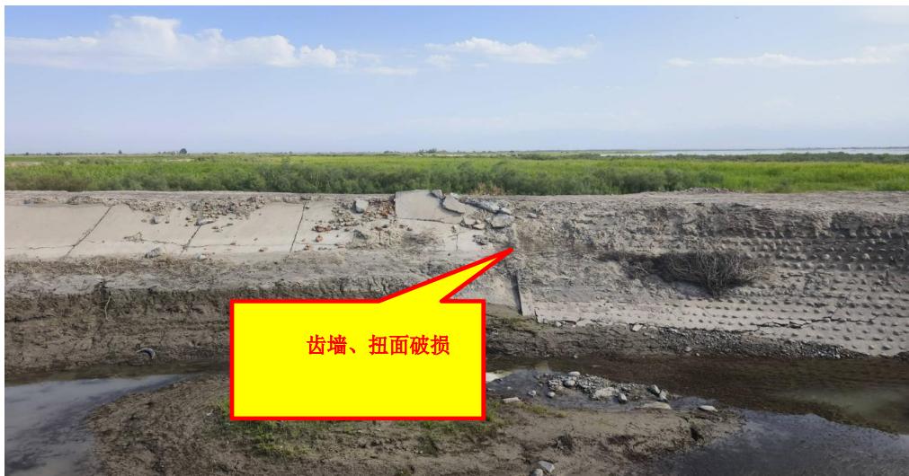
水库进水口扭面前护坡裂缝
