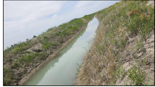
洪通道壅水行洪能力不足
